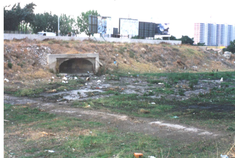
sbocco acque piovane e reflue
